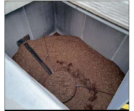
CHAUFFERIE. Ce nouveau mode de chauffage va suffire pour plusieurs équipements municipaux.
