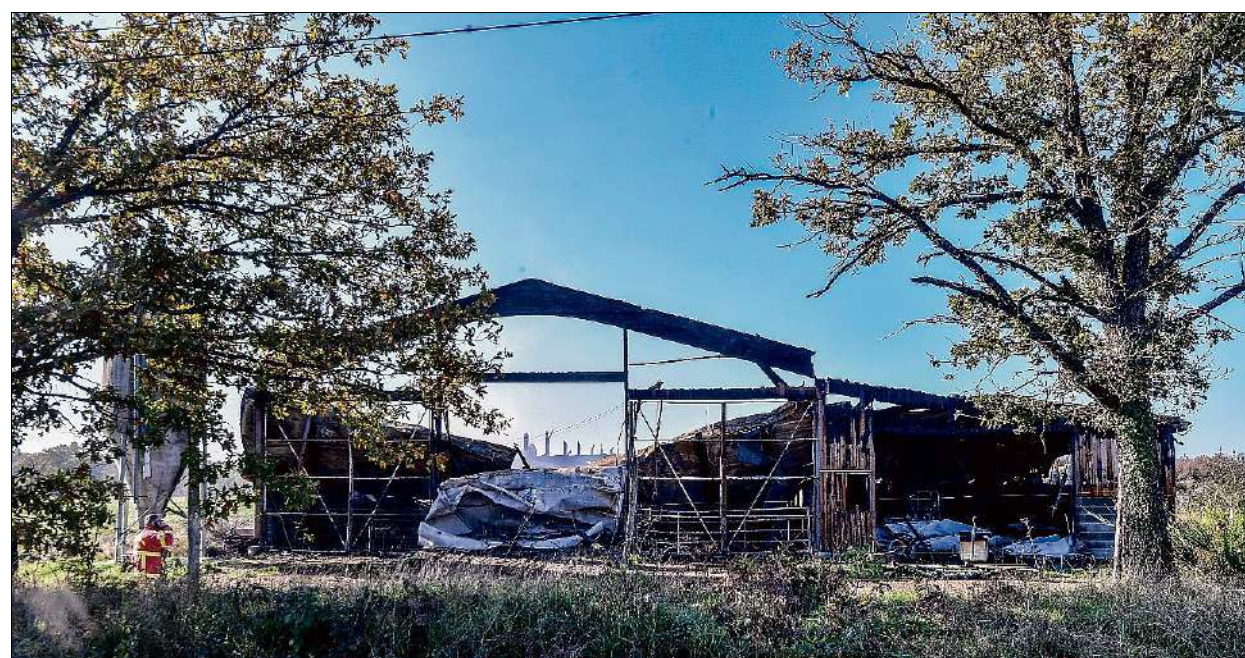
DÉGÂTS. Le site a été placé sous surveillance car le reste du bâtiment menace de s'effondrer. PHOTO : MARINE ASTIER
